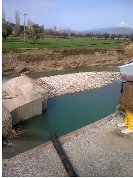
Şekil 3.4. Gökçeler'deki köprü, 2009-2010 kışındaki yoğun yağışların ardından ırmağın taşması sonucunda yıkılmış durumda.
